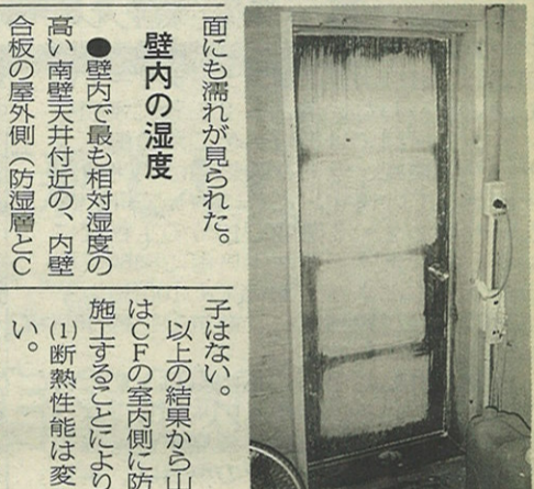
激しく結露するドア(防湿層あり)
